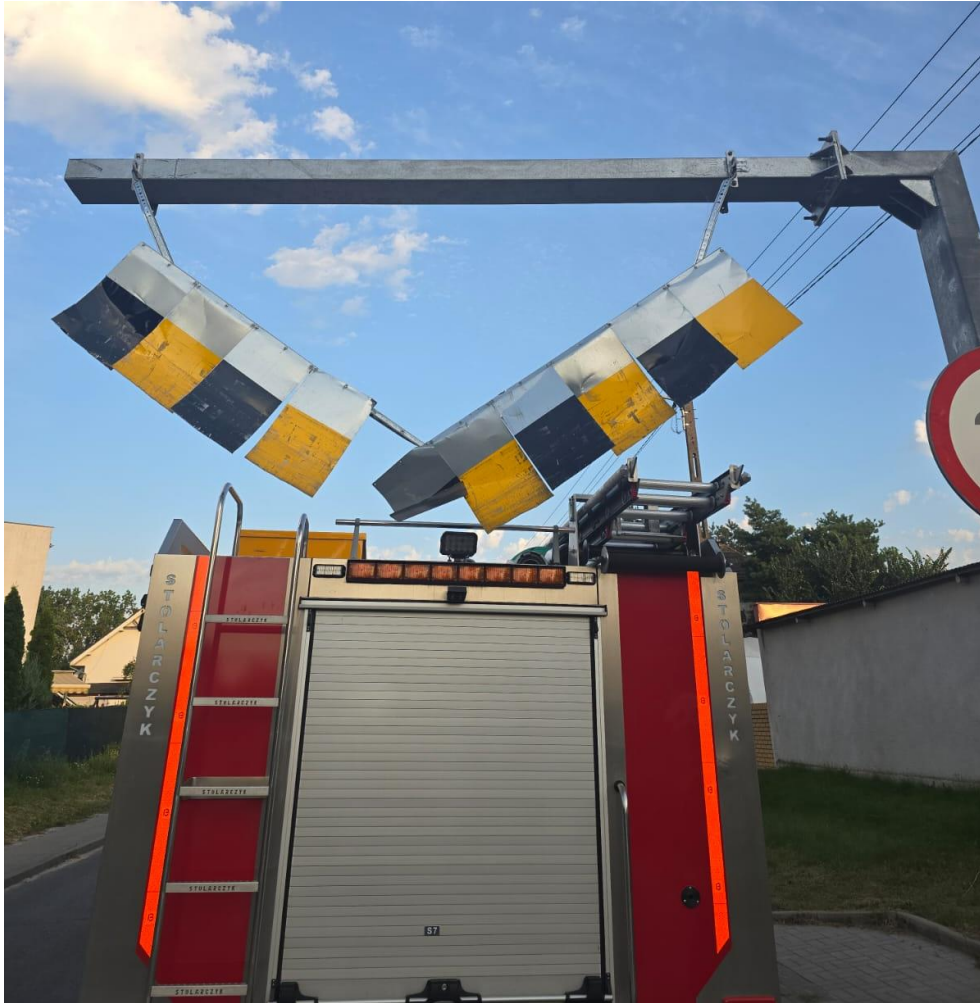
Wiry ul. Łęczycka – usunięcie uszkodzonego ogranicznika wysokości pojazdów, 13.08.2025
