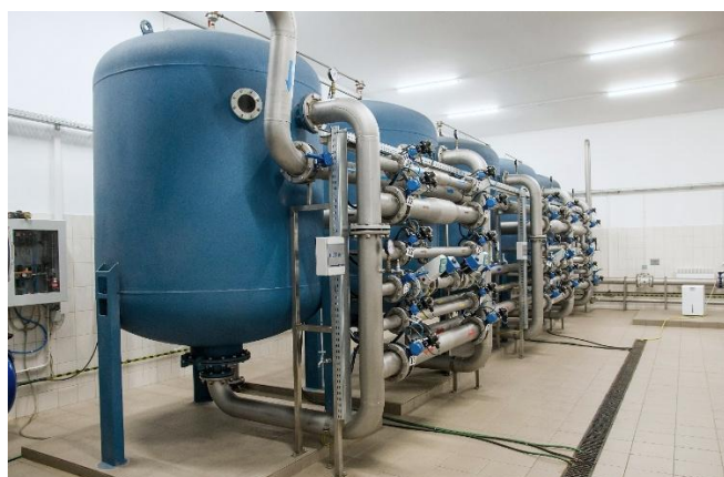
Wnętrze Stacji Uzdatniania Wody Plewiska 2
